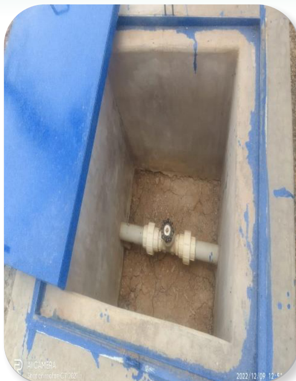
Foto 6. Recorriendo la matriz principal del sistema de riego
