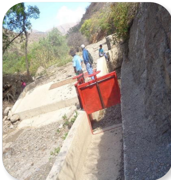
Foto 6. Toma del río Duraznillos que alimenta a la represa.
